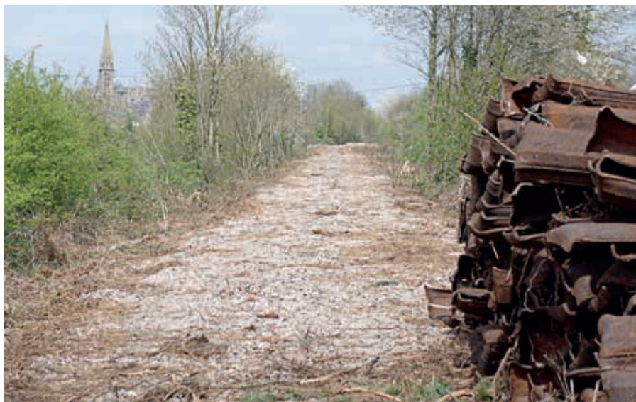
Première phase des travaux de la voie verte : débroussaillage et dépose des rails.
