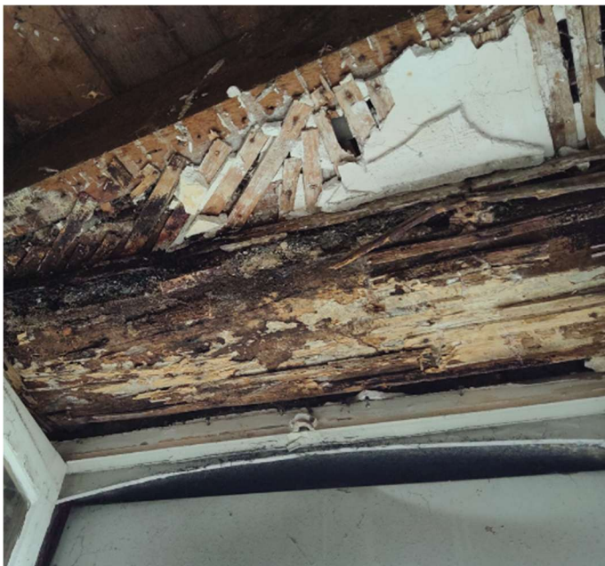
Attention cependant aux solives de rive. La solive doit être déposée, remplacée.
